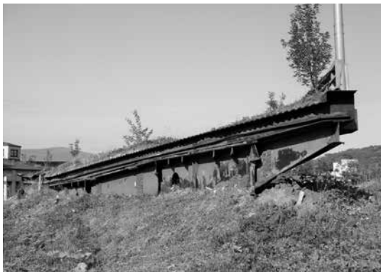
写真1 熱泥流で押し流された国道橋
